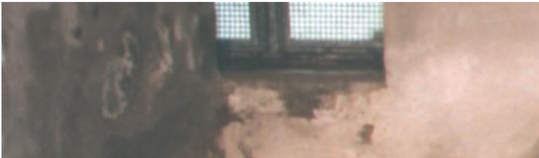
Abb. 3.: In einem feuchten Keller können keine Sachen gelagert werden. Die Kellerräume sind für die Mieterinnen und Mieter bzw. die Eigentümer nutzlos.
